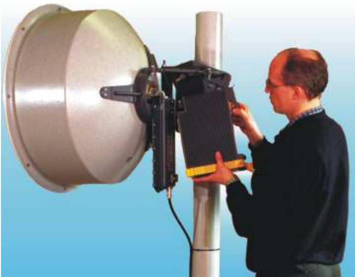
Abbildung 11: Installation eines High-End-Mikrowellen- Richtfunksystems CBL-Link 26/155 mit 60 cm-Antenne
